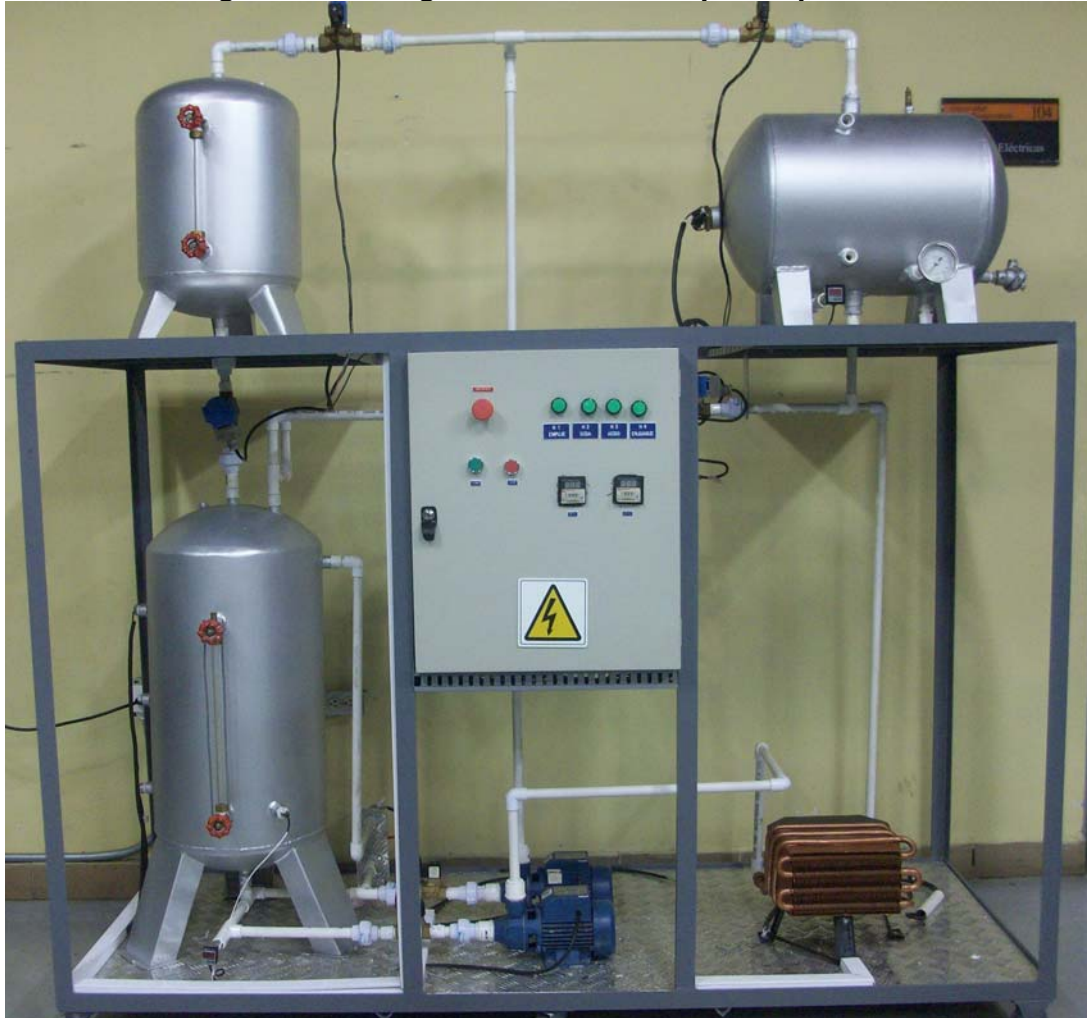
Figura 29. Configuración final de la planta piloto.
