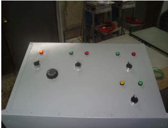
Figura 27. Tablero de control
