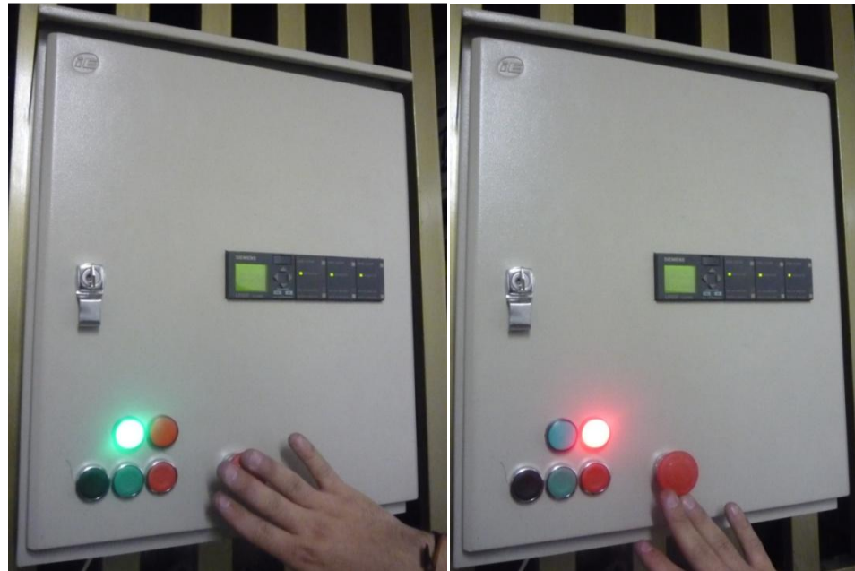
Figura 86. Pruebas de encendido y comprobación de conexiones para verificar que no hubiera problemas como cortos eléctricos y/o problemas de ruido eléctrico.
