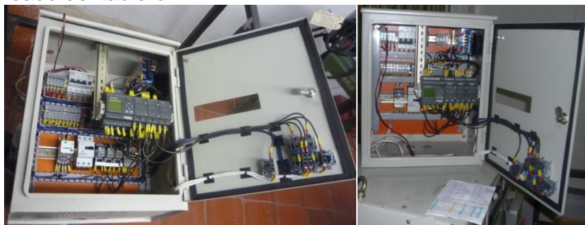
Figura 85. Cableado del tablero:
