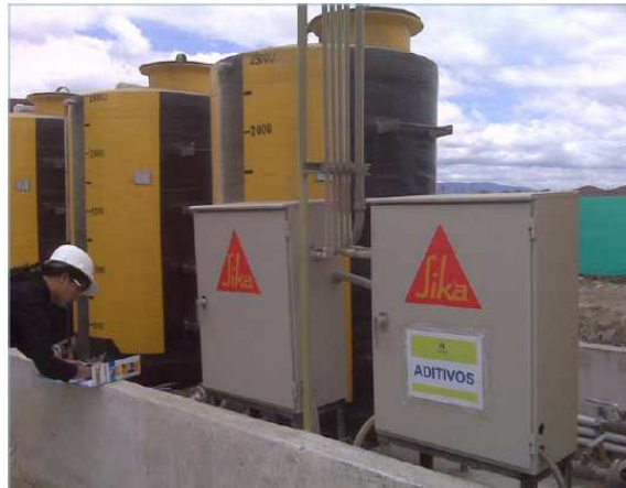
Imagen 1. Tanques para aditivo y tableros de control 1
