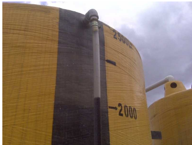
Imagen 25. Mirilla del tanque de aditivo 2
