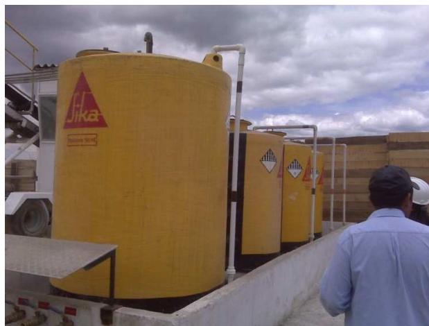
Imagen 2. Tanques para aditivo 1
