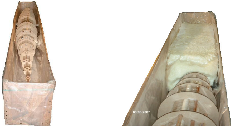
Figura 180. Reacción de los componentes A y B (poliuretano) en la caja con la estructura guía.
