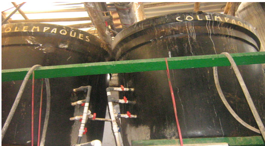
Foto 22. Depósitos de Tratamiento.
